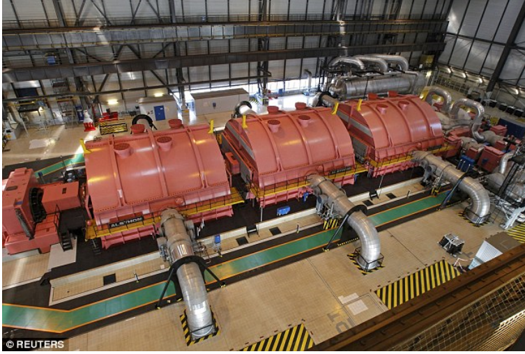
Şekil 4: Patlamanın olduğu türbin ve jeneratör binası içinden bir görünüş
